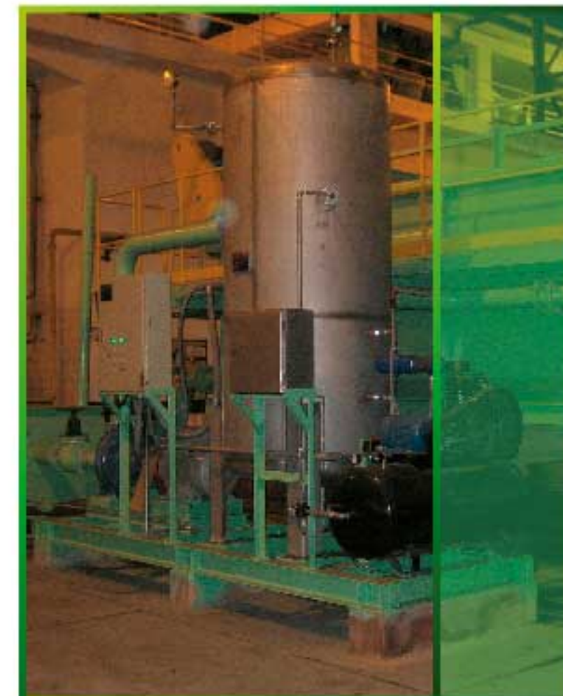
Sistema de Presurización DAF
