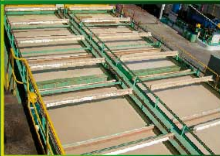
Sistema DAF en Operación.
