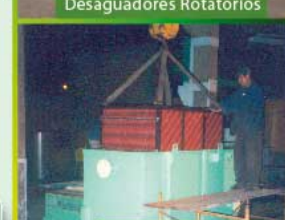
Ensamble de Placas Coalescentes.
