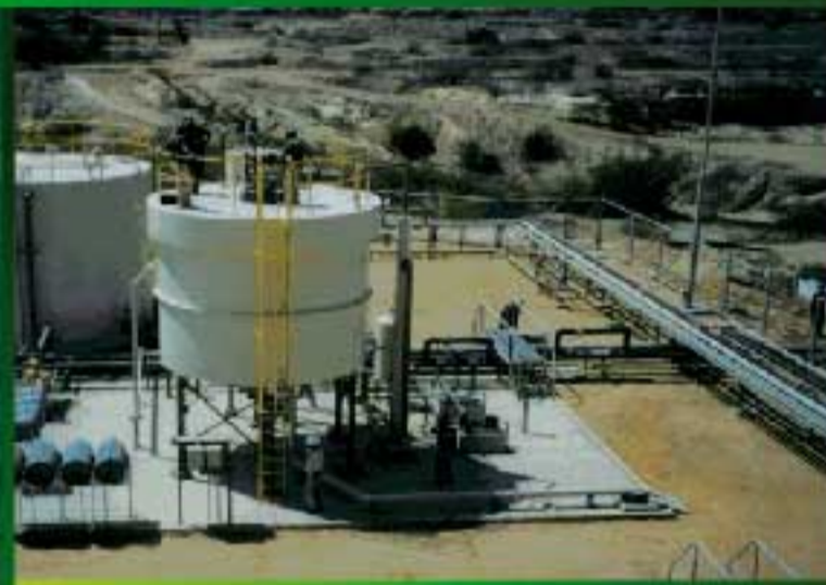
DGF Planta de Tratamiento Crudo
