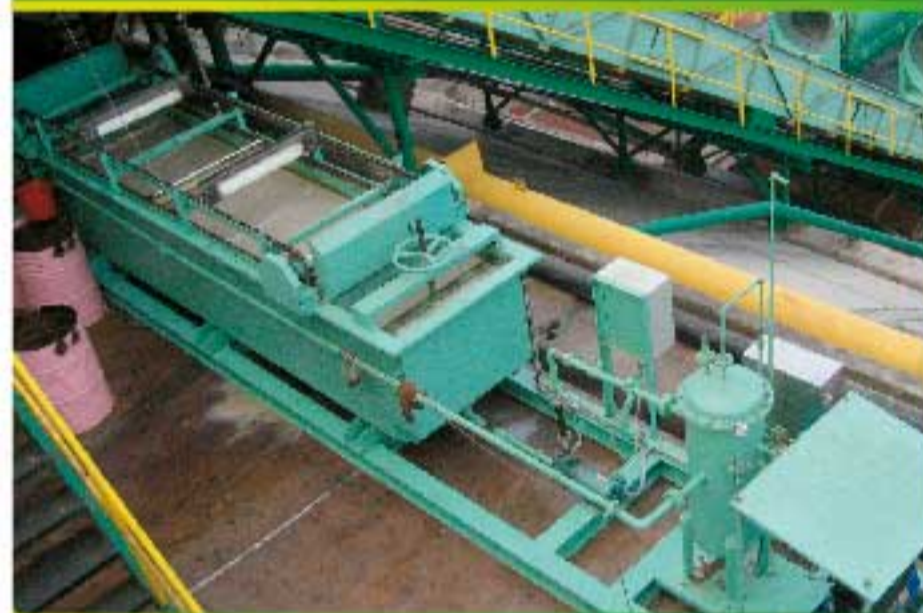
Sistema DAF en Chancay
