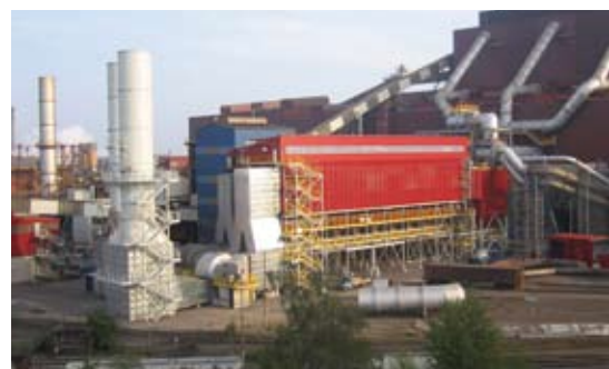
Filtro de cámara en la industria del acero
