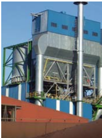
Filtro resistente a los impactos de presión para la captación de polvo en una instalación trituradora de carbón
