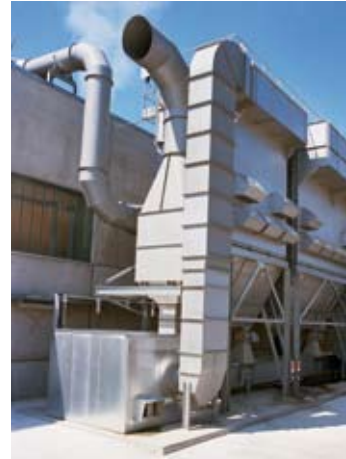
Filtro en serie en la industria de materiales derivados de la madera
